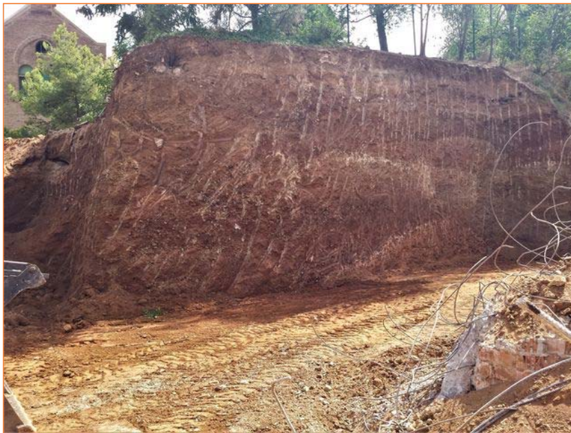
Foto 15. Detall del perfil de l'enjardinament SO finalitzats els treballs de rebaix
